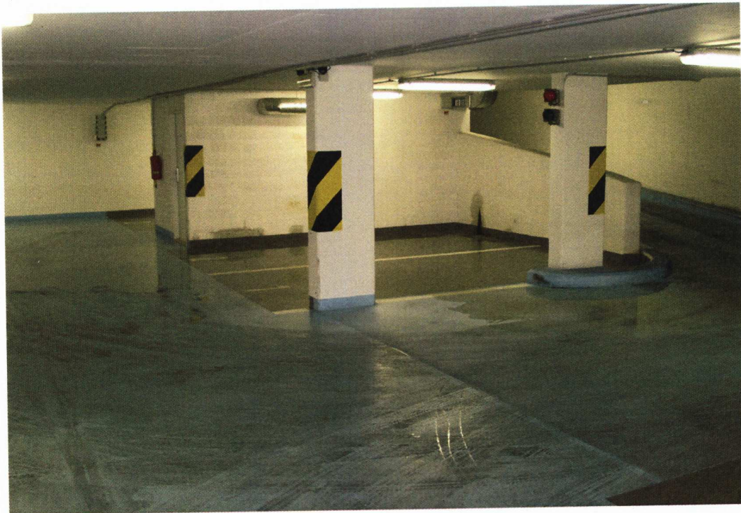
2. PP, pohled směrem k rampě, kaluž vody u garážových stání 1 a 2
