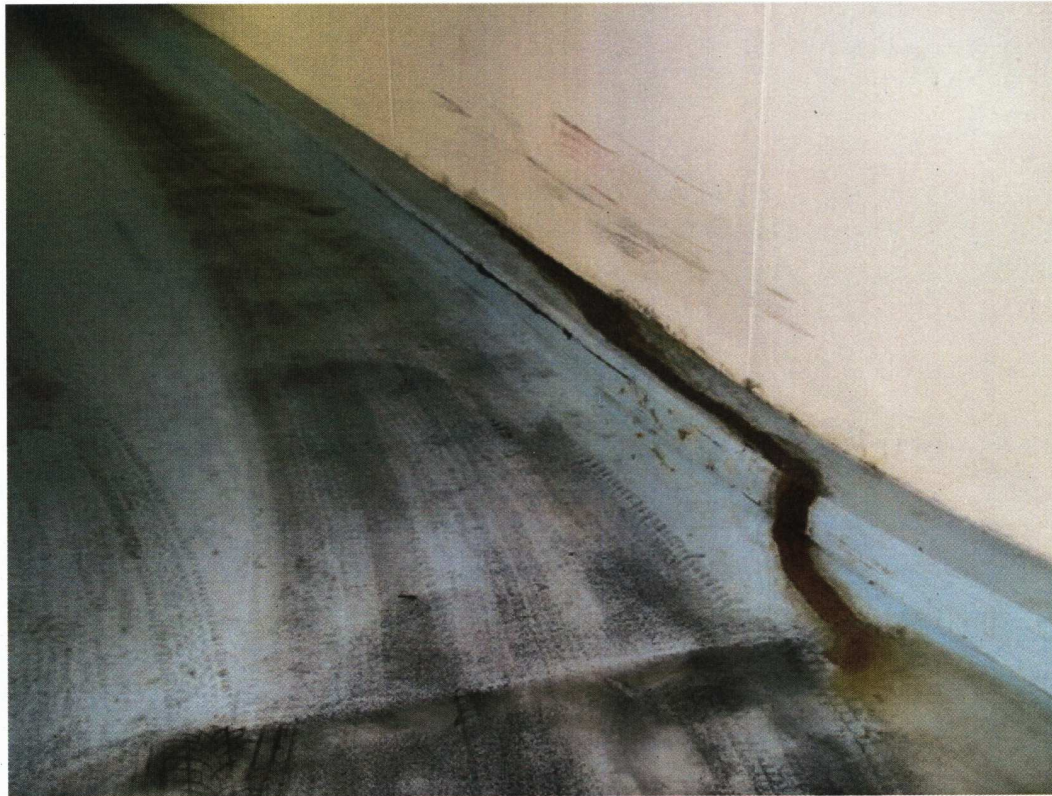
Příjezdová rampa, výluhy a vyvěrající voda mezi konstrukcí rampy a obvodové stěny
