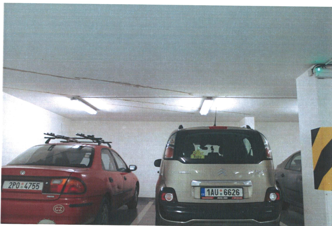
Fotografie sanovaných trhlin ve stropě garáží. Sanace provedena z důvodu zatékání přes stropní konstrukci z garážových stání 1.PP.
