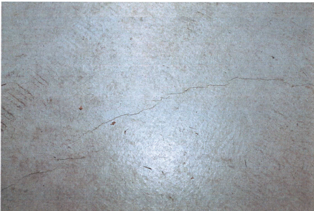
Fotografie tahové trhliny v podlaze v 1. PP.
