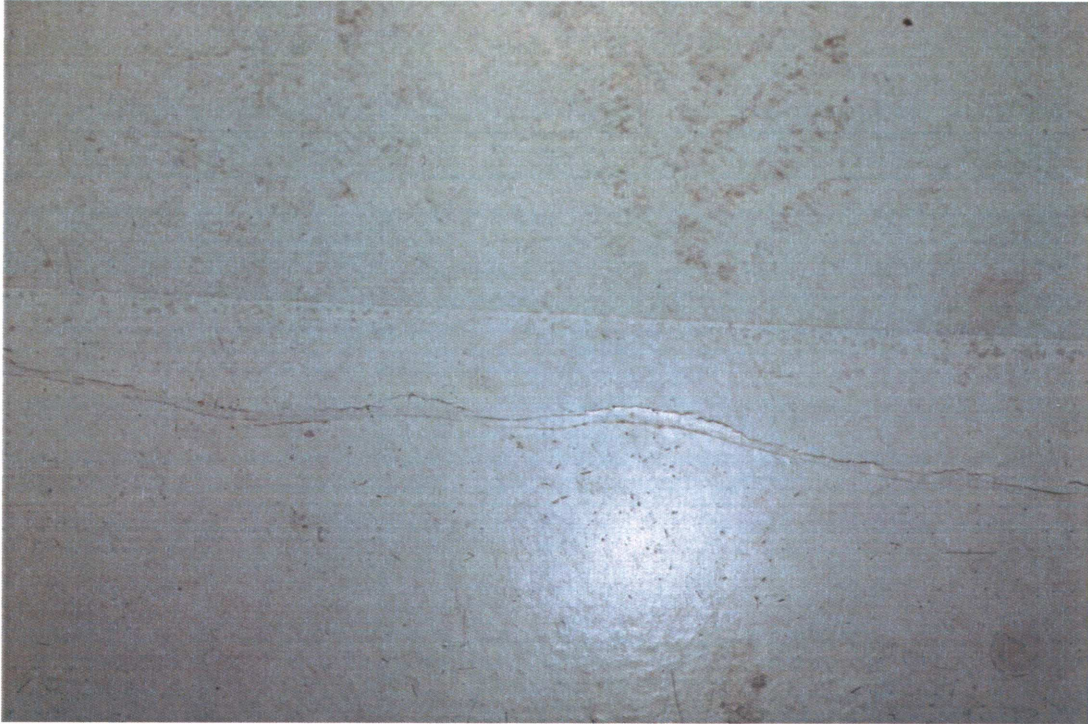
Fotografie trhliny v podlaze v 1. PP. Dle stavebně technického stavu se jedná o tahovou trhlínu.
